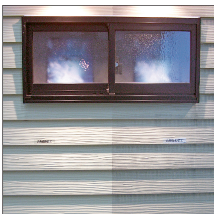
Beispiel einer photokatalytisch ausgerüsteten Wandbeschichtung (links), rechts: Standardbeschichtung nach Bewitterung Quelle: Sto AG
